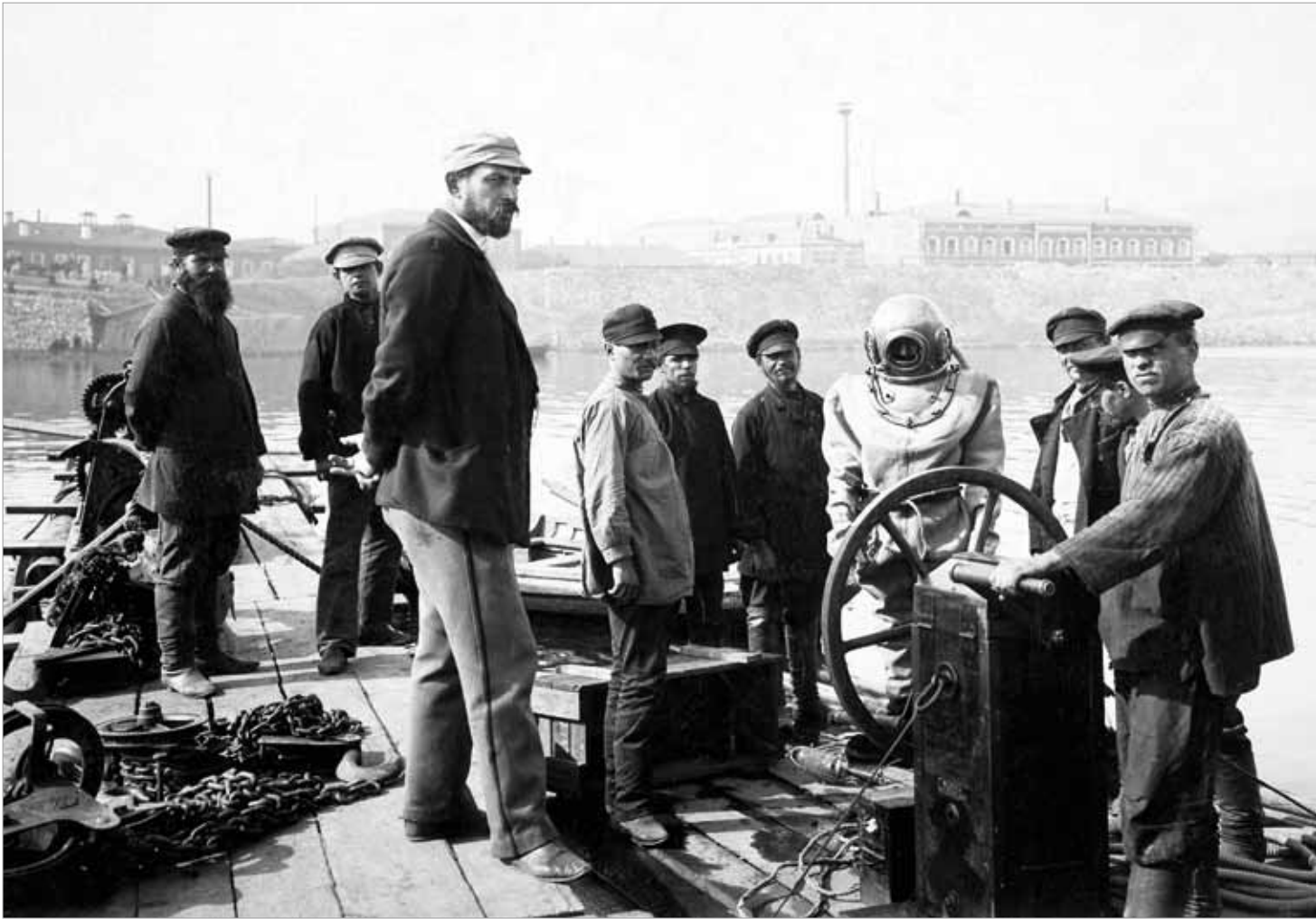
1910 год. Водолазная станция на строительстве водовода через Москва-реку в районе Краснохолмского моста
